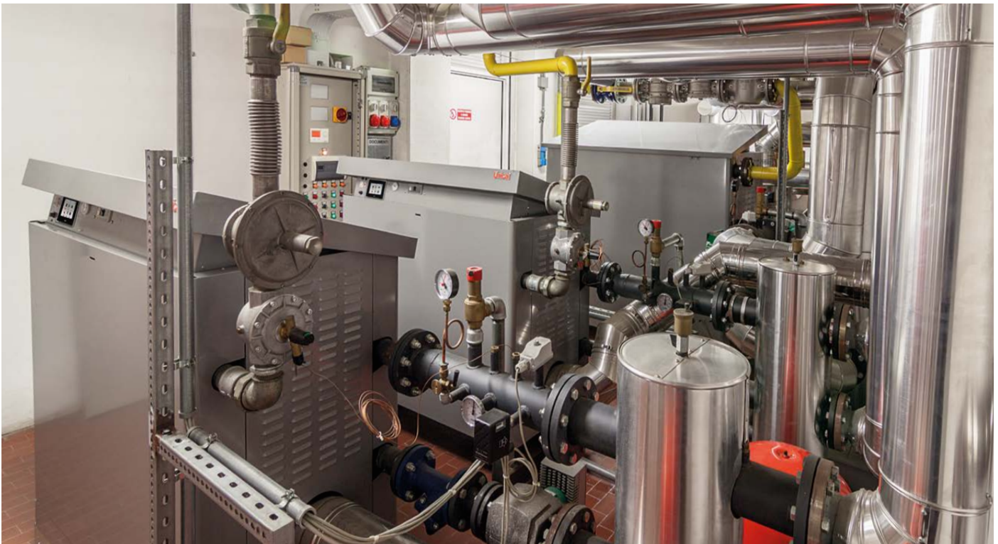
INSTALLATION IN EINER HEIZZENTRALE
